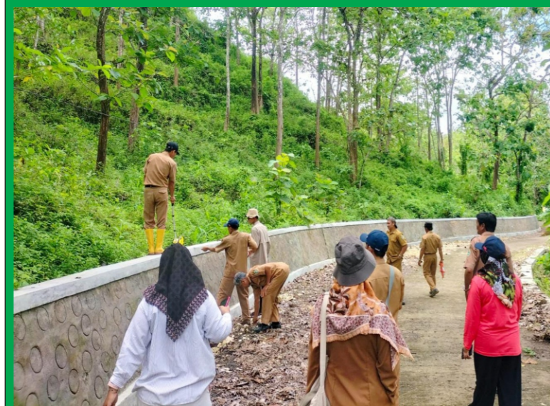
Talud Tebing Padukuhan Petir A
